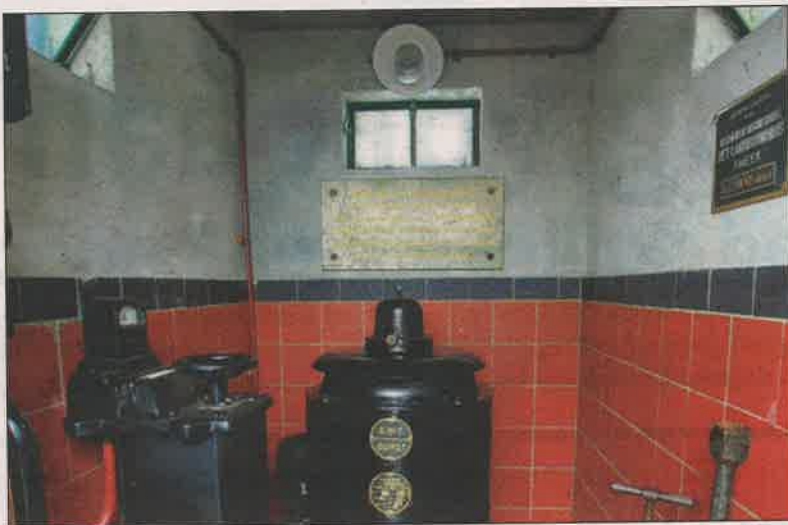
De originele bemalingsinstallatie (1930) in het pompstation langs de N225.
