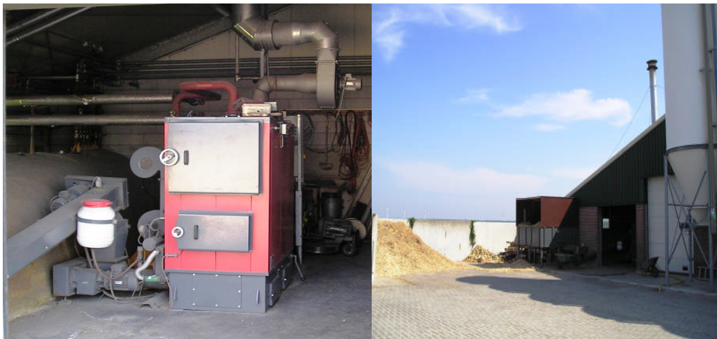
Houtchips verbrandingsinstallatie van 250 kWth in Zeewolde bij een varkenshouderij
