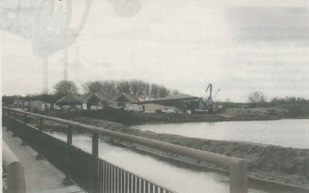
Het bestaande pand uit 1994 moest worden geopend naar het omringende landschap en de zon.
